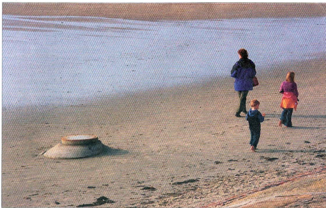
Über die Seewasserleitung, deren Anschluss-Stützen am Strand von Norderney zu sehen ist, wird das Norderneyer Badehaus stets mit frischem Meerwasser versorgt.
