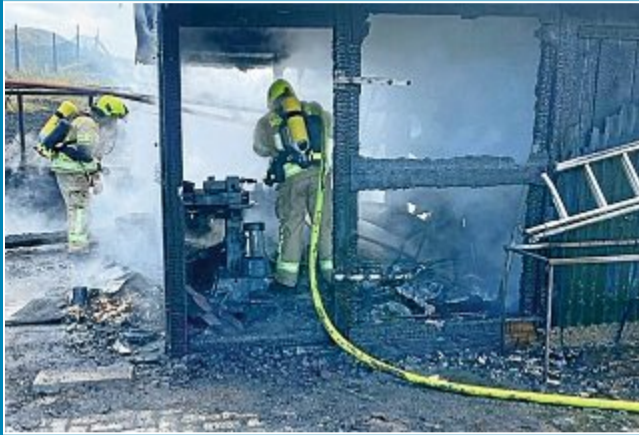
Bei einem Brand im Inselosten wurde ein Schuppen vollständig zerstört. Schuld war wahrscheinlich das Ladegerät eines E-Bikes.
