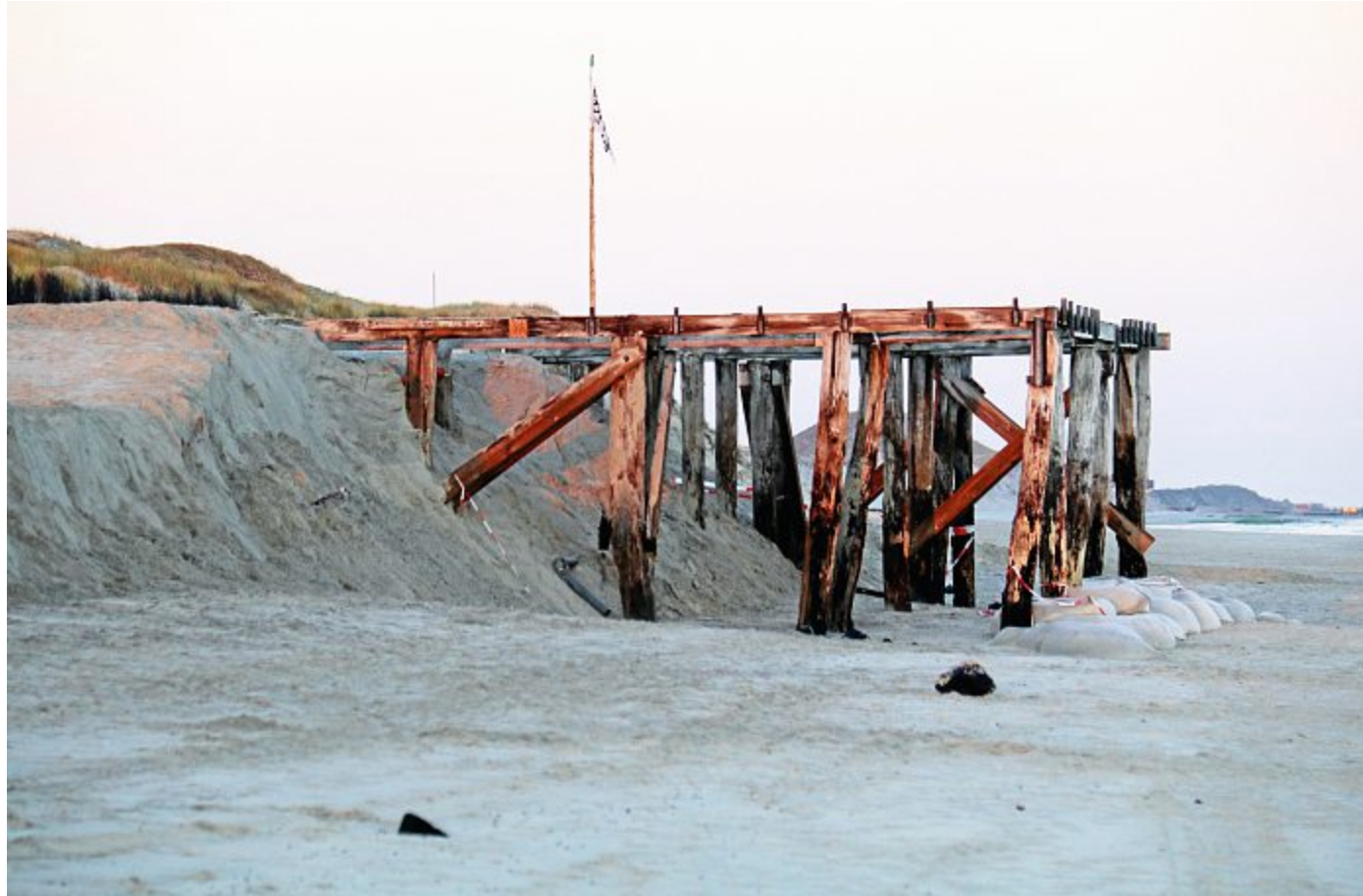
Die Holzkonstruktion an der Weißen Düne wurde bei der ersten kleinen Sturmflut massiv unterspült.
