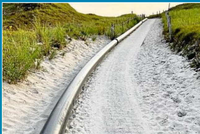
Rückspüleleitung für die Horizontalbohrungen schlängeln sich durch die Dünentäler bis zur Inselmitte.
