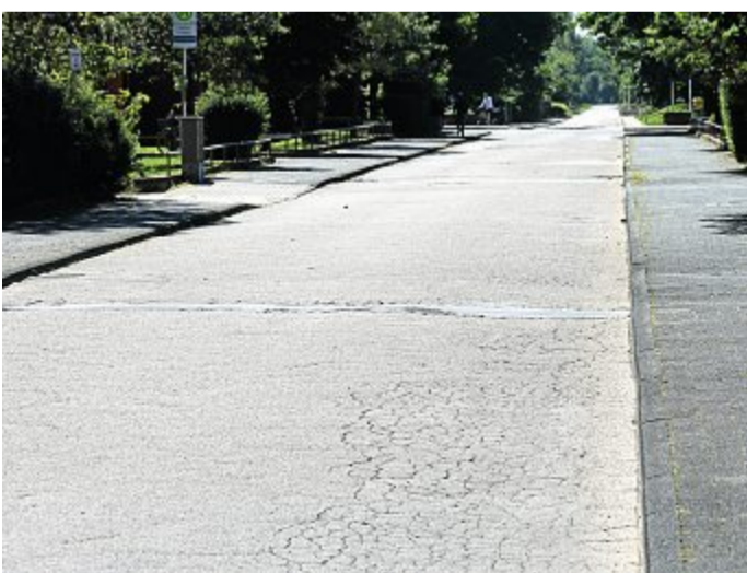
Der jetzige Zustand der Mühlenstraße ist marode.
