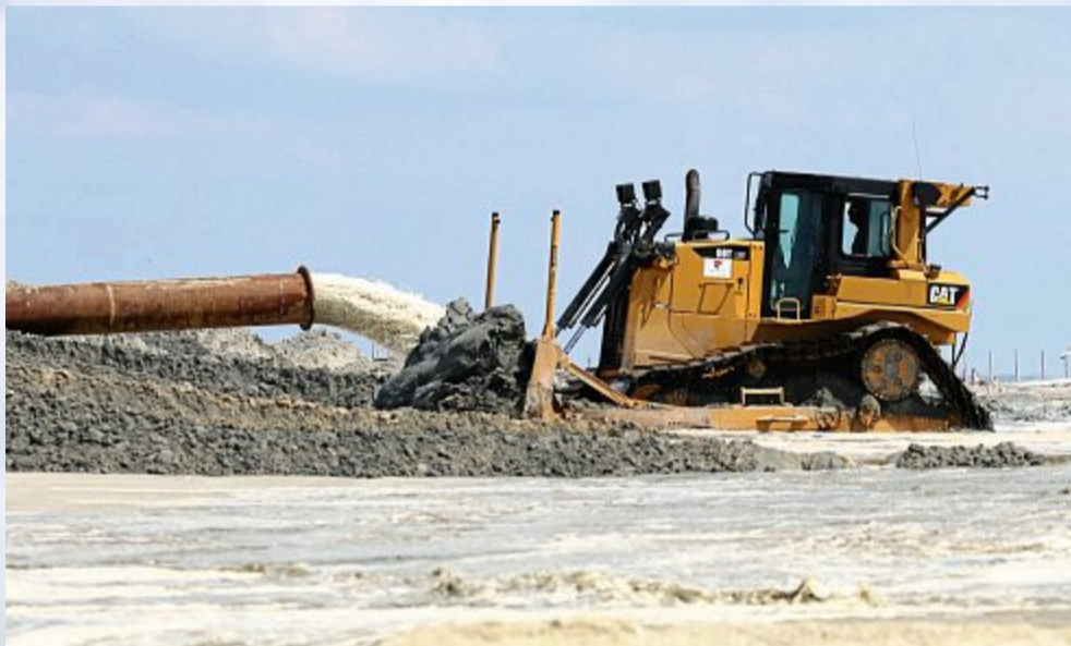
Mit schwerem Gerät gegen die Wassermassen.
