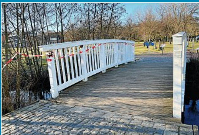
Die Fußgängerbrücke im Park ist renovierungsbedürftig.
