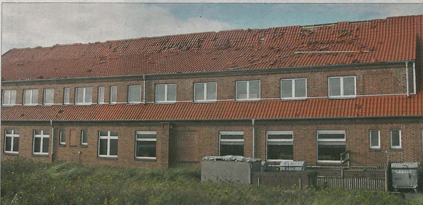
Erst vor wenigen Jahren wurde das Dach des Jugend- und Gästehauses Detmold an der Lippestraße erneuert. Jetzt ist es schon wieder großflächig reparaturbedürftig. FOTO: HAHLBOHM
