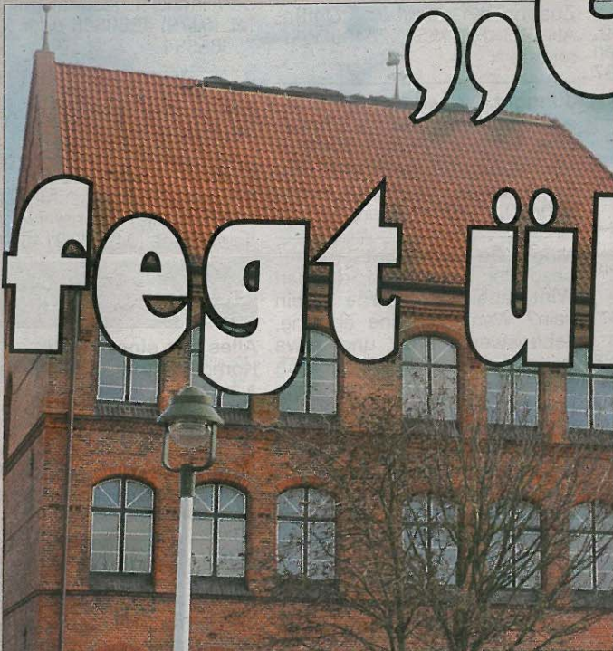
Auch das noch relativ frisch renovierte Dach der Grundschule hat Schaden genommen.
