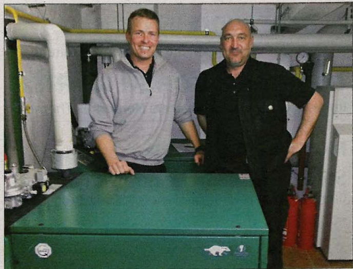
Maik Andersen (l.) und Kolja Schäfer von der Firma Rosenboom an einem bereits installierten Dachs-Blockheizkraftwerk.
