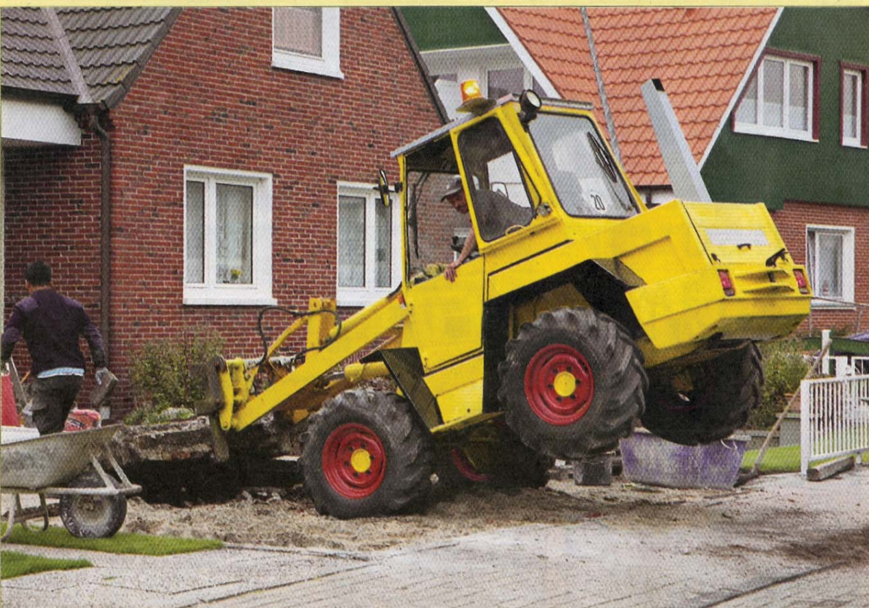
Kleine Flugstunde für diesen Radlader: In der Oderstraße auf Norderney ist schweres Geschütz notwendig, um die Umbaumaßnahmen rund um dieses Eigenheim zu vollziehen.
