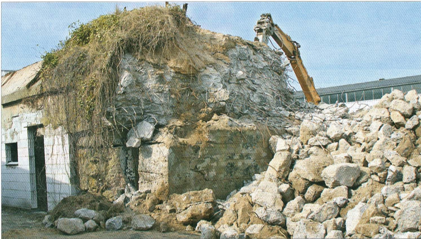
Die Beseitigung eines Bunkers im Gewerbegebiet erfordert viel Arbeit und hohe Kosten.
