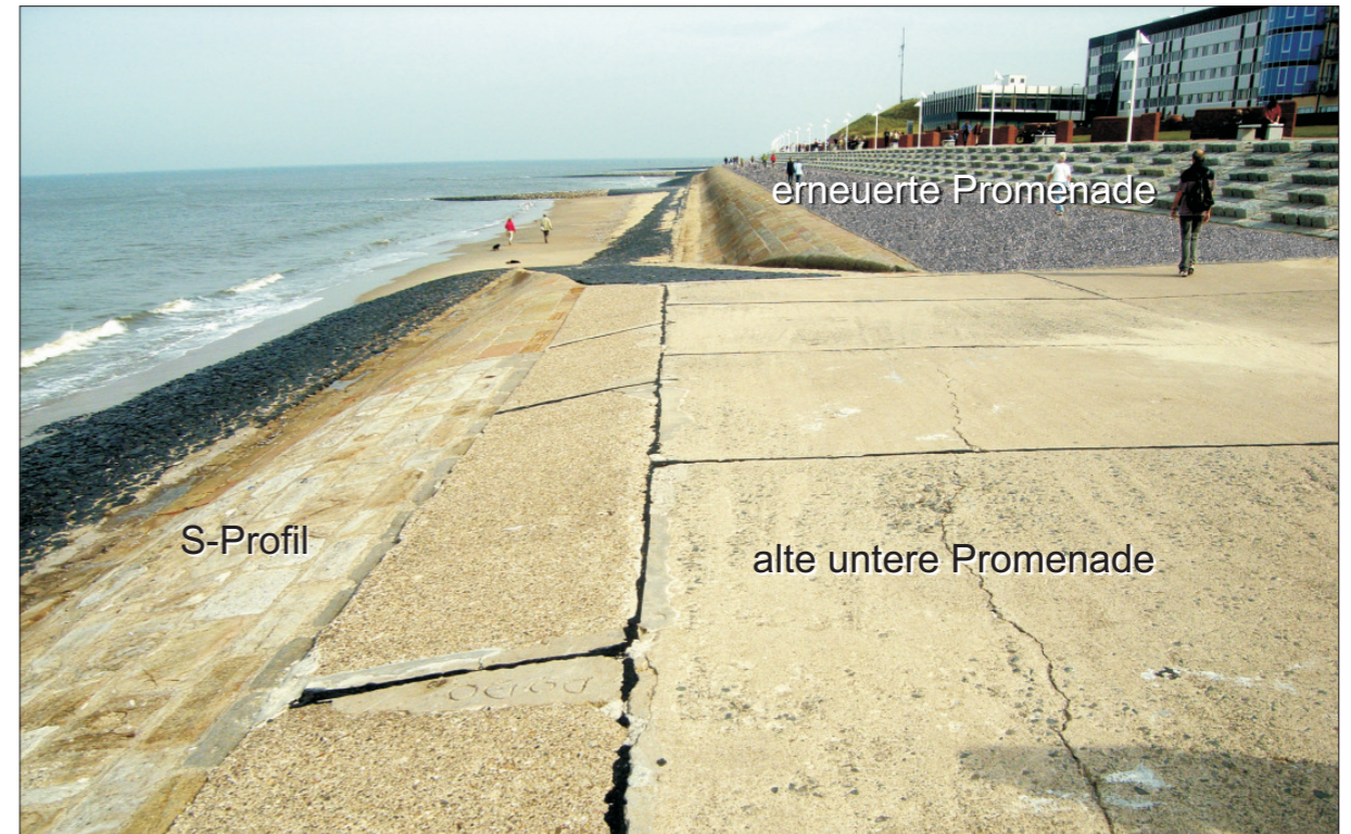
Abb. 2: Schadhafte Betonplatten der unteren Promenade
