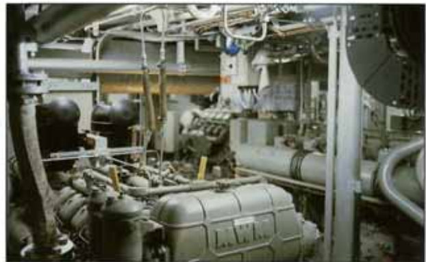
In den Maschinenräumen der FRISIA-Schiffe be-finden sich neben den Hauptmotoren eine Reihe weiterer Hilfsmaschinen und Aggregate, die für die Erzeugung von elektrischem Strom (380/220 V), für Pumpen, Steuerungs- und hydraulisch be-triebene Anlagen und Einrichtungen des Schiffes benötigt werden und aus Sicherheitsgründen viel-fach auch doppelt vorhanden sind.
